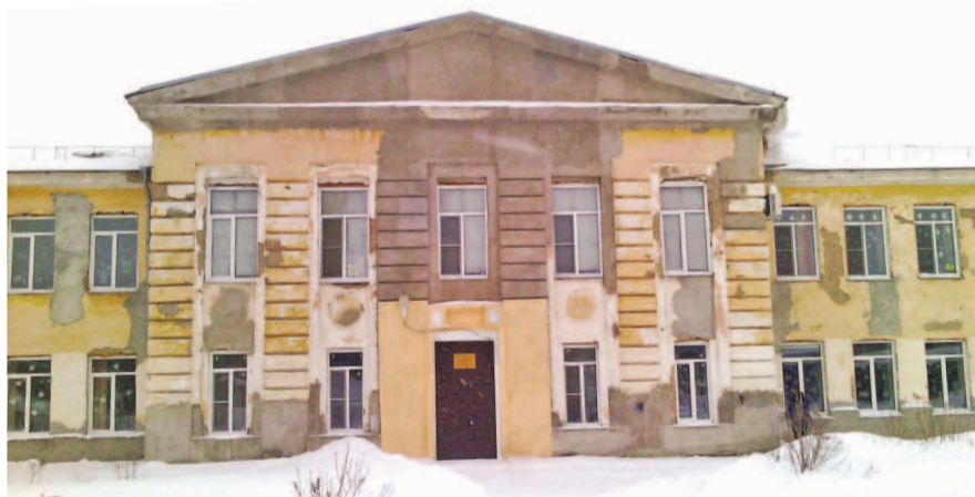
НА ФОТО: ШКОЛА №18 НЕ РЕМОНТИРОВАЛАСЬ 35 ЛЕТ
