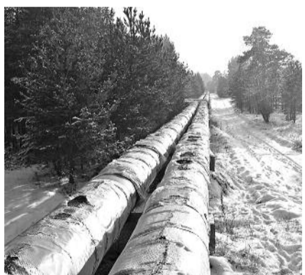
● НА ФОТО: ЭТА ТЕПЛОТРАССА НЕ ВЫДЕРЖИВАЕТ УЖЕ НИКАКИХ МОРОЗОВ...
