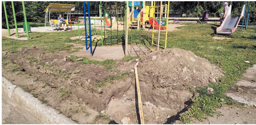
НА ФОТО: ОСТАНОВИТЬ СТРОЙКУ НЕЛЬЗЯ, МОЖНО СНЕСТИ НЕЗАКОННО ПОСТРОЕННОЕ
