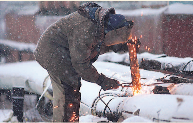
НА ФОТО: НЕОБХОДИМ СВОЕВРЕМЕННЫЙ РЕМОНТ
