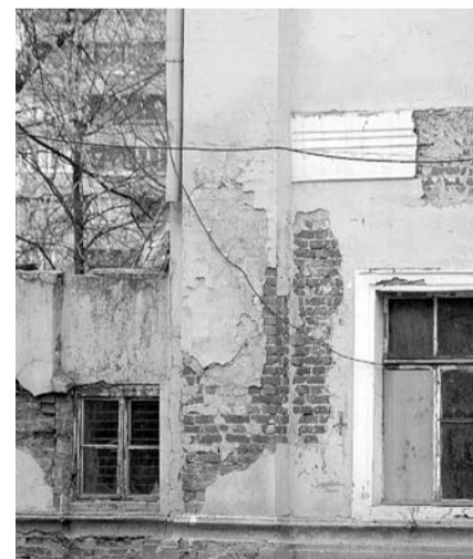
НА ФОТО: В ОЖИДАНИИ КАПРЕМОНТА...
