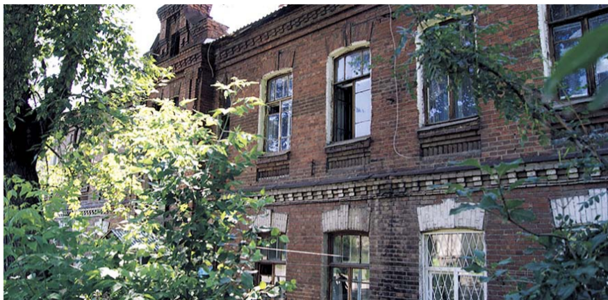
НА ФОТО: ОБВЕТШАВШИЕ ДОМА ДАВНО НУЖДАЮТСЯ В РЕМОНТЕ
