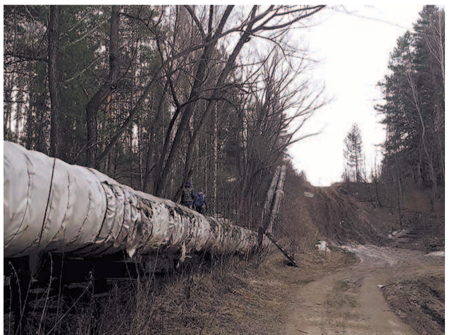
НА ФОТО: ПО ТЕПЛОТРАССЕ, КАК ПО ДОРОГЕ
