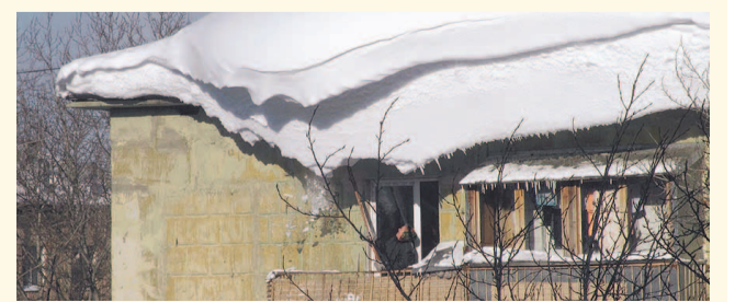
НА ФОТО: КРЫША РИСКУЕТ ОБВАЛИТЬСЯ
